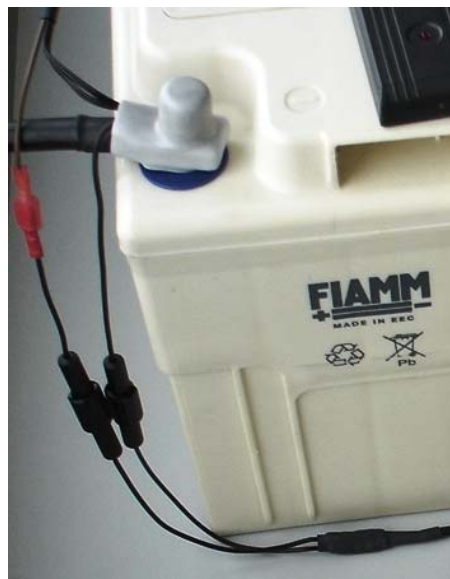
Abb.4 Blick auf Y-Kabel zum Anschluss des Batterie-Minus-Poles an den Koppler STK
